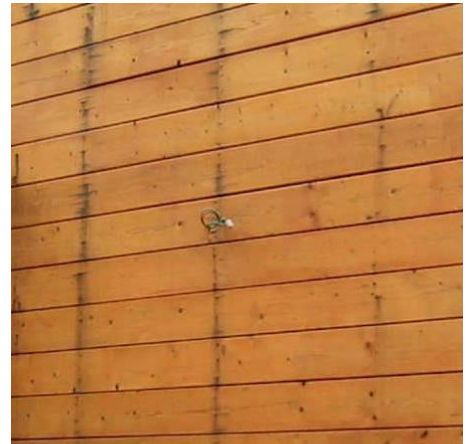
Vlekvorming rondom de bevestigingspunten als gevolg van corrosie.
